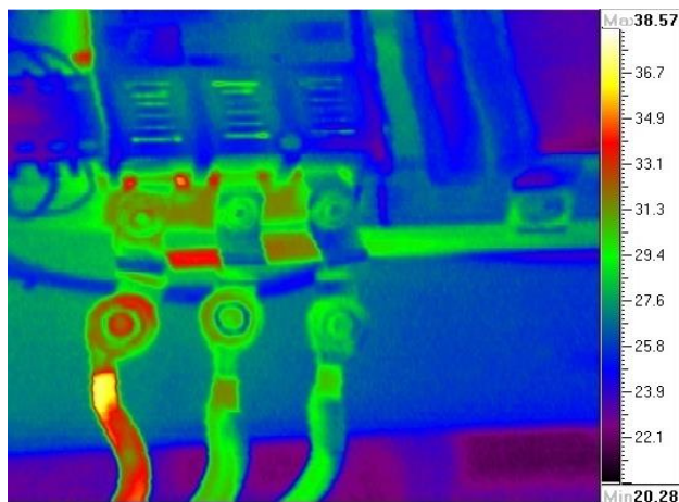
Рисунок 21. Пример термограммы контактных соединений с температурной шкалой
