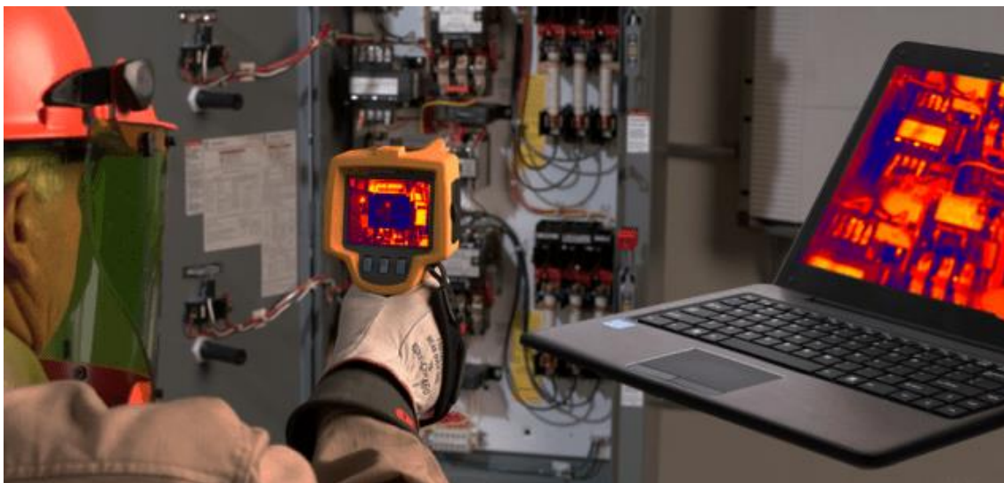
Рисунок 20. Пример проведения тепловизионного контроля электрошкафа
